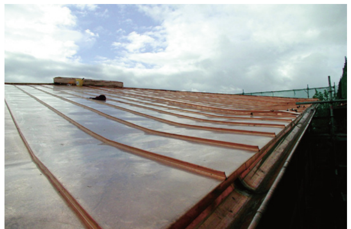
Bild 6: Schräg zu den Scharen verlaufender Innenknick, von der Traufe bis zur Dachmitte.
