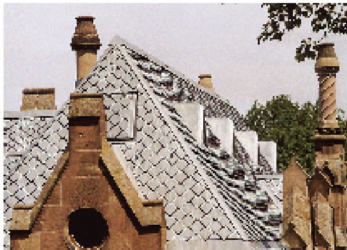
Bild 10.: Teilansicht des neu gedeckten großen Walmdaches mit eingebundenen Spitzgauben, dem Grat-, First- und Traufbereich sowie den harmonisch integrierten Ziergiebeln und Schornsteinen aus Sandstein.
