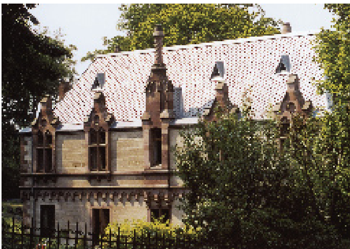
Bild 11.: Im Zusammenspiel traditionsreicher Metaldachdeckung und der schön gegliederten Sandsteindetails der Südfassade zeigt sich die gekonnte Verbindung von zwei auch heute hoch aktuellen Werkstoffen.
