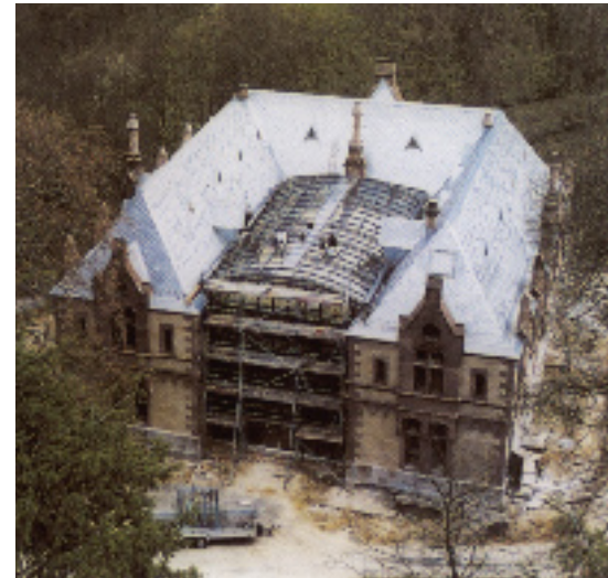
Bild 5.: Ein Jahrhundert später: Das dreifach gegliederte Dach der Vorburg ist neu gedeckt, der Innenhof erhält eine gewölbte Metall/Glas-Überdachung.
