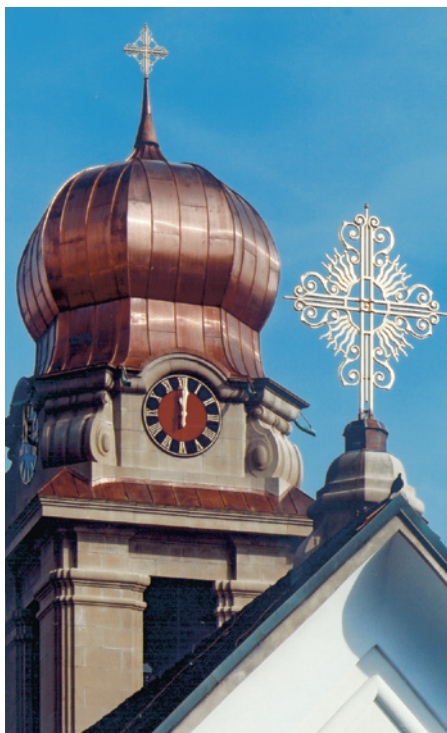
Bild 2.: Der barocke Zwiebelturm und die vergoldeten Kreuze erstrahlen wieder im ehemaligen Glanz.
