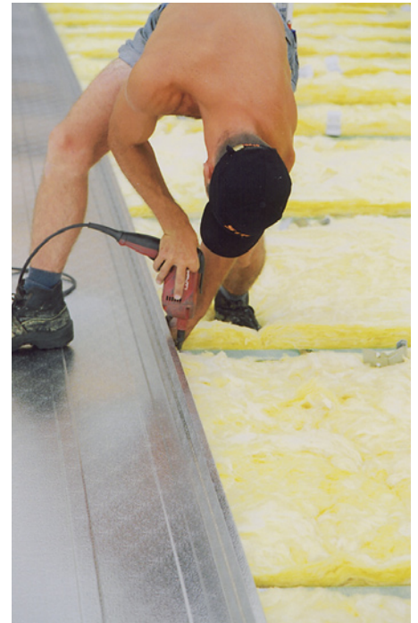
... und mit elektrischer Hilfe rasch verschraubt. Die Abstände der Befestigungselemente wurden in Abhängigkeit der zu erwartenden Windlasten ermittelt. Es bedarf keiner zusätzlichen Folie zwischen Wärmedämmung und den Profilbahnen, da die Mineralwoll-Dämmung komprimiert wird.
