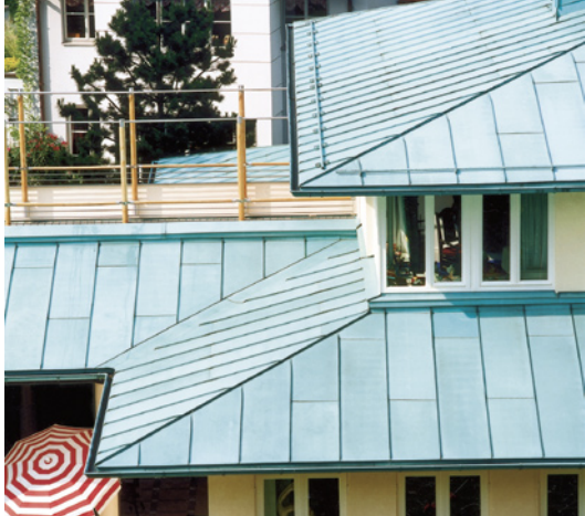
Walmdächer auf einer Villa in München-Grüntal. Tafeldeckung in Doppelstehfalztechnik, ausgeführt in Tecu-Patina von dem Spengler-Fachbetrieb Propst aus Planegg. (Foto: KME, Osnabrück)
