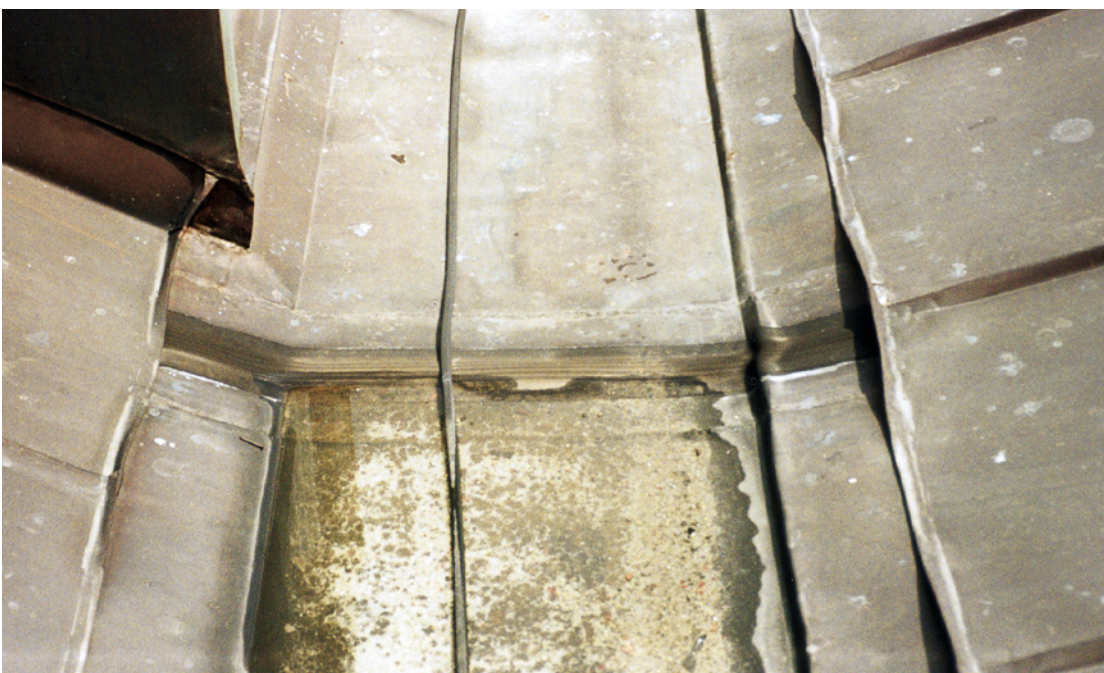
Bild 5.: Der Bewegungsausgleich sollte am Scheitelpunkt der Grabenrinne angeordnet sein, damit das anfallende Regenwasser von hier aus nach links und rechts ablaufen kann. Offensichtlich gibt es aber sogar ein Gegengefälle, da hier stehendes Wasser direkt am Dehnungselement zu erkennen ist.
