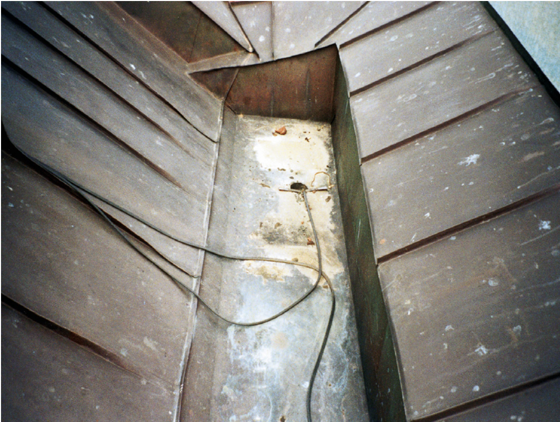
Bild 4.: Trichterförmige Einlauföffnungen sollen wegen des wesentlich besseren Schluckvermögens selbstverständlich sein, heißt es in den Klempnerfachregeln. Ebenso selbstverständlich müssen bei innenliegenden Rinnen Sicherheitsüberläufe (Notüberläufe) vorhanden sein. Beides ist hier erkennbar nicht der Fall.
