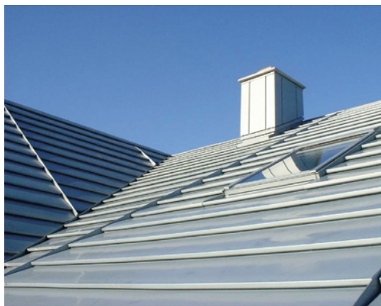
Bild 3.: Von außen ist nicht zu erkennen, dass es sich hier um ein Solardach handelt. Unter den Solarthermie-Paneelen aus Rheinzink befinden sich Solar Kollektoren.
