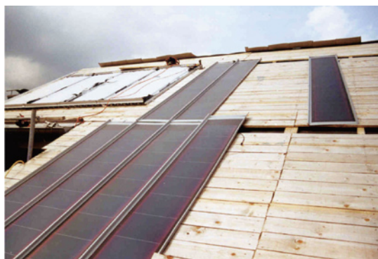
Bild 4.: Eine Kombination von Photovoltaik-Paneele und verglasten Solarkollektoren (links oben)
