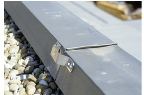
Eine starre Blitzschutz-Überbrückung behindert die Wärmedehnung dieser Attikaabdeckung.
