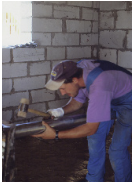
Lepel: Herstellung eines Rohrfalzes unter erschwerten Bedingungen in einem zur Werkstatt umgebauten Stallgebäude.
