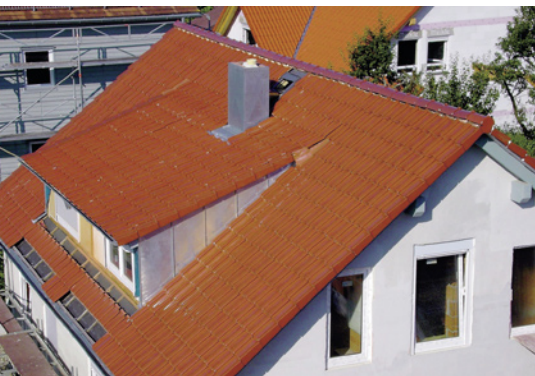
Bild 2: Kupferdachfirst und mit Zink bekleidete Dachaufbauten: Kontaktkorrosion vorprogrammiert.
