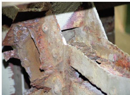
... und auch die Stahlunterkonstruktion war hoffnungslos vom Rost zerfressen.
