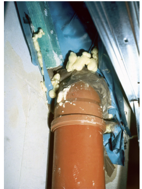
Bild 18.: Falsch geplante Rohrdurchführung durch das geneigte Dach. Das Rohr liegt zu dicht an der Wand. Diese Situation lässt sich aus handwerklicher Sicht nicht luftdicht ausbilden.
