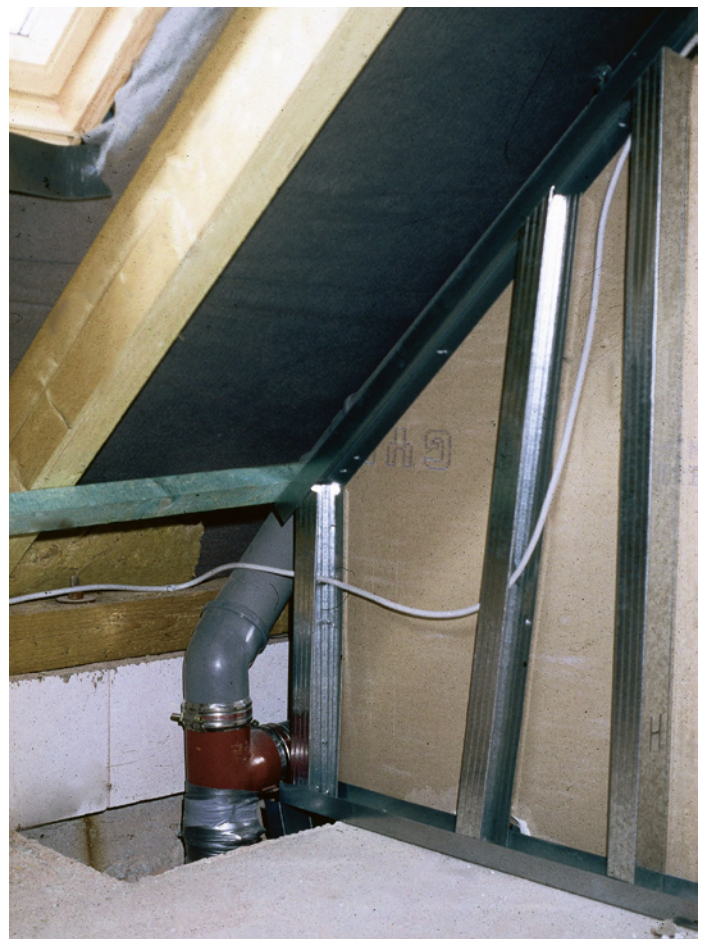
Bild 23.: Diese Trennwand stellt ein Hohlkammersystem dar. Die luftdichte Schicht des Daches darf nicht an diese Wand angeschlossen werden, sondern muss in der Ebene des Daches über dieser Wand durchlaufen.
