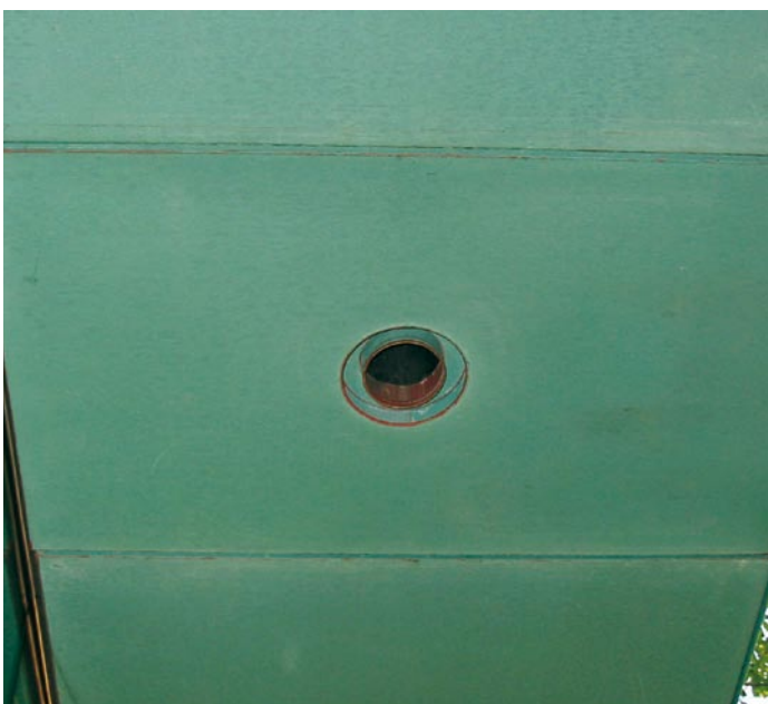
Saubere Einfassung eines Notüberlaufes für den darüber liegenden Balkon.
