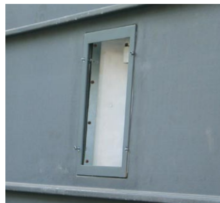
Bild 5.: ... und einen in die Fassade integrierten Kasten, dessen später hinzugefügte Glasscheibe die Hausnummer angibt und von innen beleuchtet ist.
