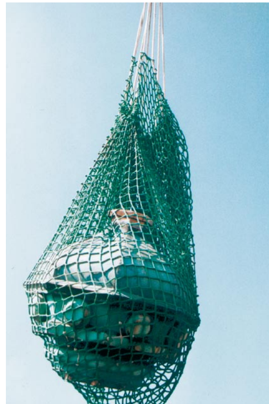
Bild 8.: Getragen von einem Helikopter, schwebt die gewaltige Zierkugel zu der auf der Turmspitze vorbereiteten Halterung.
