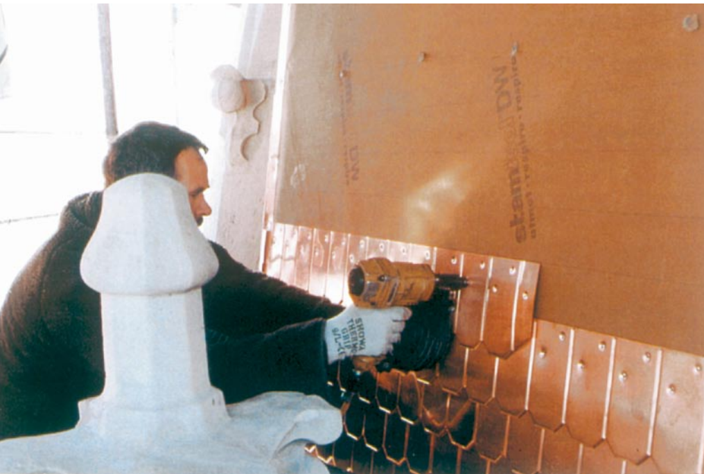
Bild 3.: Selbst gefertigte Schindelreihen statt einzelner Schindeln werden auf der mit einer Trennlage versehenen Holzschalung mit einem elektrisch betriebenen Nagelgerät befestigt.
