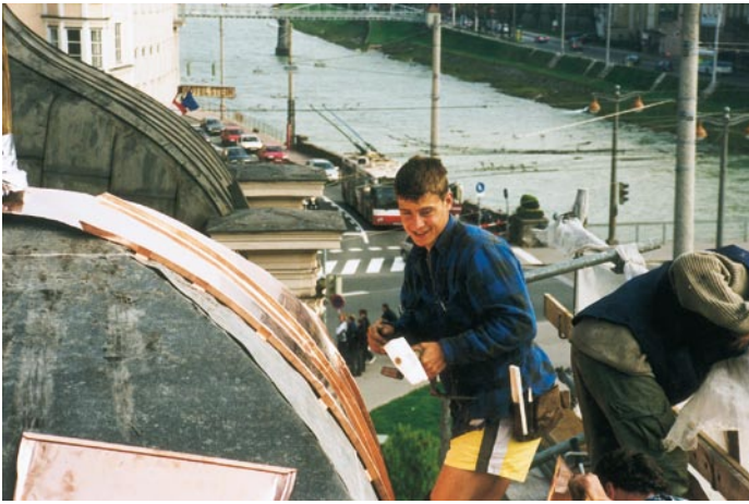
Bild 15.: Der Spengler-Junggeselle Martin Gollackner hat offensichtlich Freude bei der Eindeckung einer der kleinen Dachkuppeln mit den maschinell gerundeten Kupferscharen.
