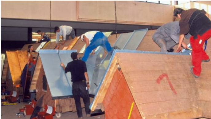
Die Teilnehmer konnten die Materialwahl und die Einteilung der Scharen weitgehend selbst gestalten, aber auf eine fachgerechte Ausbildung der An- und Abschlüsse wie auch auf materialgerechten Werkzeugeinsatz wurde geachtet.
