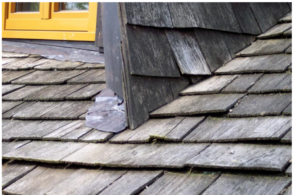
Bild 2.: Zustand der Dachdeckung aus Zedernholzschindeln nach 25 Jahren.
