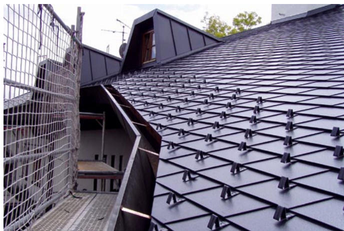
Bild 14.: ... und nach der Neudeckung. Dachschindeln mit bauseits montierten Schneestoppnern verhindern jetzt das Abrutschen von Schnee.
