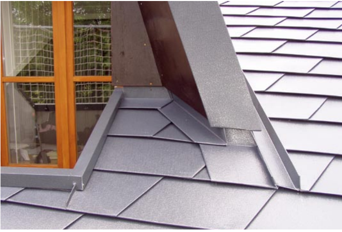
Bild 15.: Während die Dachflächen einfach einzudecken sind, fordern Anschlüsse die Kunst des Klempners.
