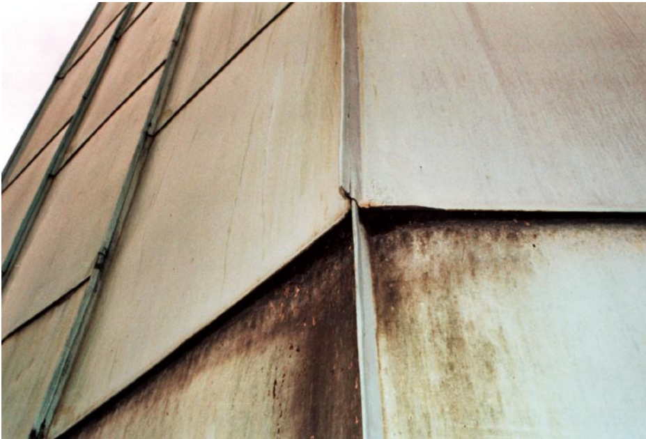
Bild 10.: Besonders auf der Wetterseite zeigen sich die typischen Auswirkungen von Sonne, Kälte, Wind und Wetter, aber auch der Luftverschmutzung.
