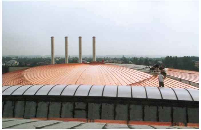
Nach der Montage der gewölbten Belichtungsbänder war der Weg frei für die Ausführung der Klempnerarbeiten. Die vier Schornsteine im Hintergrund sind keine „Kunst am Bau“, sondern gehören zu einem etwa 100 m entfernten Heizkraftwerk (Foto: Kentzler, Dortmund).
