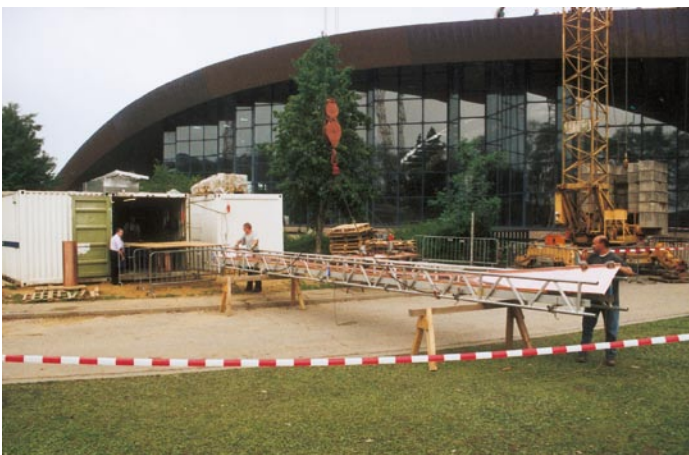
Die konischen, einseitig profilierten Kupferscharen werden aus dem Container direkt in ein Transportgestell gezogen und gelangen mit dem Turmdrehkran unmittelbar zu ihrem Bestimmungsort (Foto: Kentzler, Dortmund).
