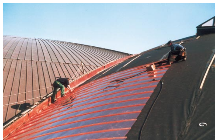
Vorsicht, optische Täuschung: die Querneigung ist größer als die Längsneigung. Das anfallende Regenwasser läuft in die Kehlrinne und springt nicht etwa über die Falze (Foto: KME, Osnabrück).
