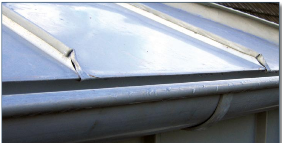
Echte Liebe zum Detail: Dieser „offene Stehfalz-Abschluss“ soll wohl in seiner Zusatzfunktion der Bewässerung des Daches dienen.
