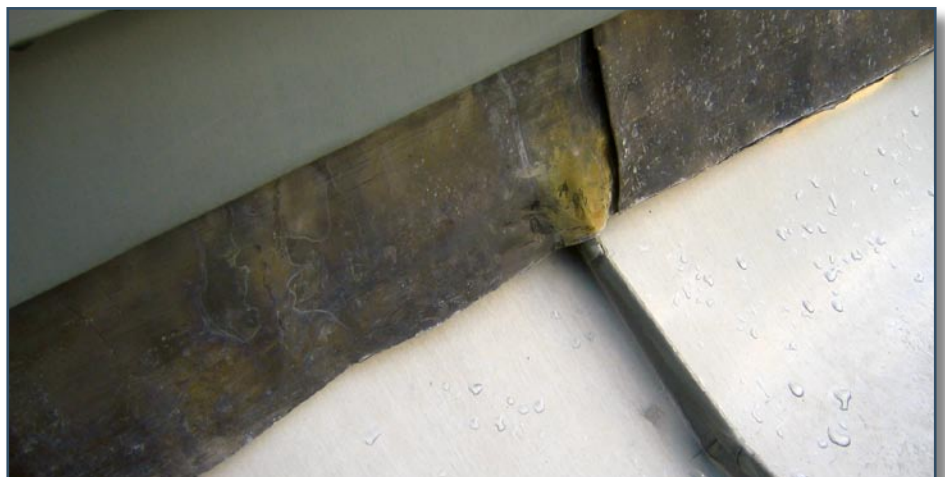
Statt Silikon-Dichtung? Dieser Übergang von der Gaubenverkleidung zum Falzdach konnte mit Walzblei-Streifen wirklich elegant gestaltet werden.
