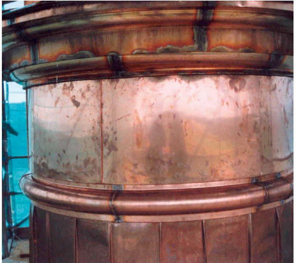
Die gebogenen Gesimse unter der Laterne wurden von der Ornament-Spenglerei Sporer aus München originalgetreu nachkonstruiert.
