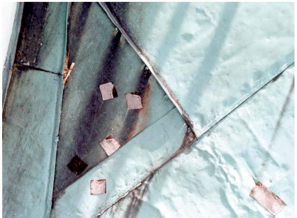
Risse, die durch Spannung entstanden waren, sind in dieser Kehle notdürftig mit Flickern repariert worden.
