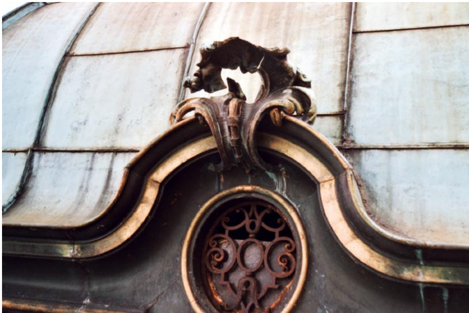
Zahn der Zeit: Die Untersuchung des Erhaltungszustandes ergab, dass die mit Kitt und Klebmassen unsachgemäß reparierten Zierornamente dennoch zu 80 % repariert werden konnten – nur wenig musste neu gefertigt werden.
