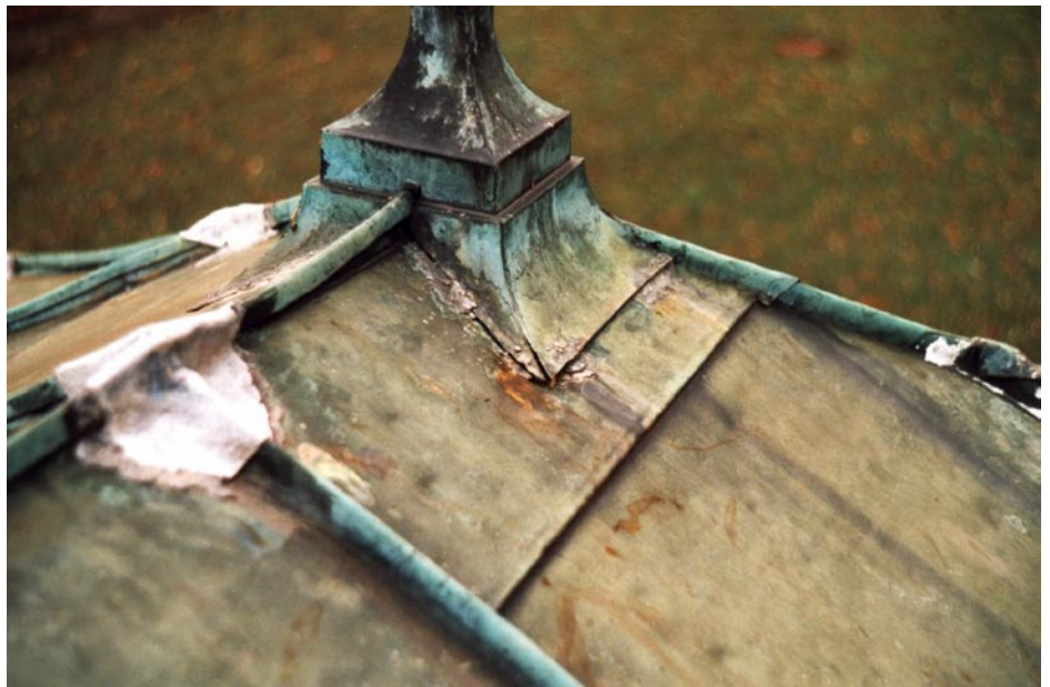
Flickwerk aus 100 Jahren: Schadhafte und undichte Stellen wurden im vergangenen Jahrhundert oft nur behelfsmäßig repariert. Eine grundlegende Sanierung war nötig, um das einzigartige Belle Epoque-Schlösschen zu retten.
