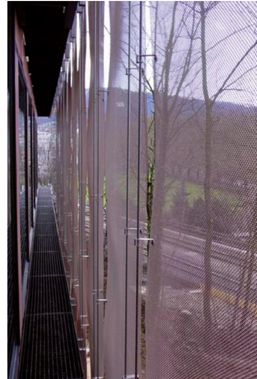
Zwischen Kupfervorhang und Fassade verlaufen auf jedem Stockwerk Umgangsstege. Sie geben den erforderlichen Abstand vor und ermöglichen die einfache Fenster- und Fassadenreinigung.
