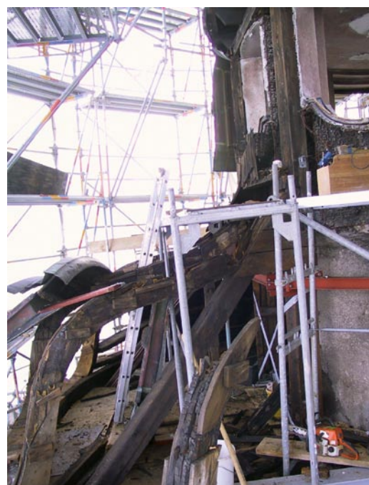
Die unsachgemäßen Reparaturen nach einem Brand hatten der Substanz der Holzkonstruktion mehr geschadet als genutzt.
