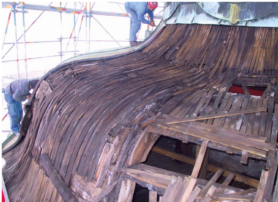
Am offenen Dach wurde erst das ganze Ausmaß der geschädigten Holzkonstruktion sichtbar.
