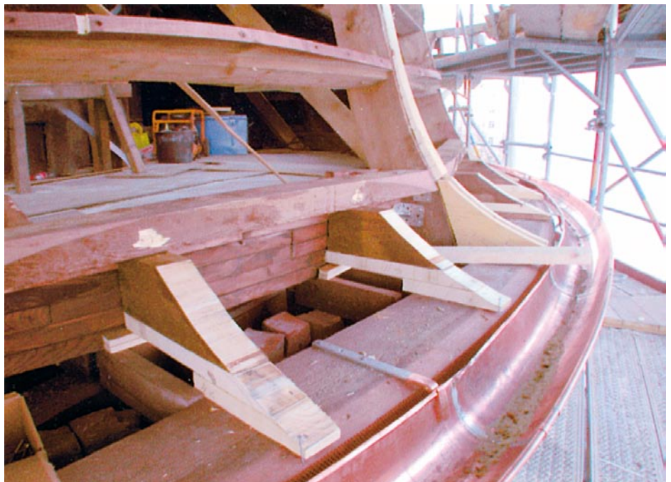
Nachdem das Gesims wieder hergestellt war, konnte die neue Dachrinne in 0,7 mm starkem Tecu Classic befestigt werden.
