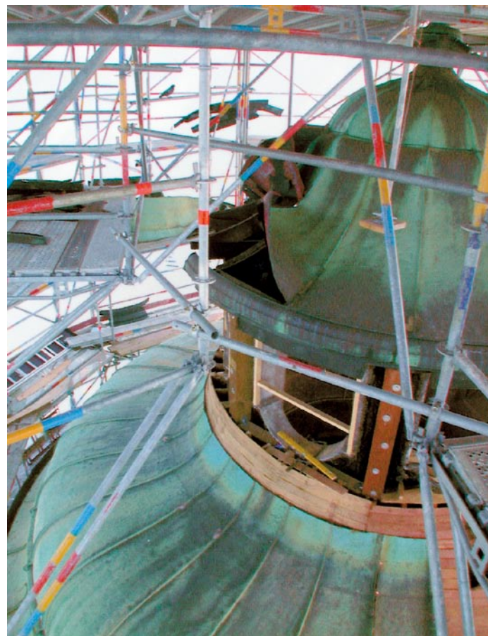
Beim Öffnen des Laternendaches wurde schnell klar, dass ein großer Teil der Holzkonstruktion verfault war.
