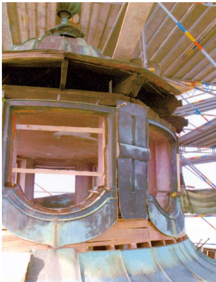
Am oberen Scharenende wird ein Belüftungsschlitz gelassen, um künftig Kondensatbildung zu vermeiden.
