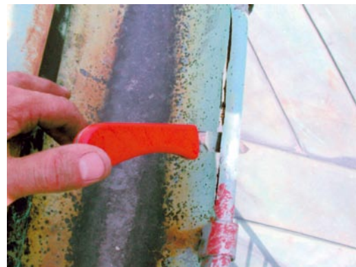
Die Regenrinne war bereits stark korrodiert und rissig.
