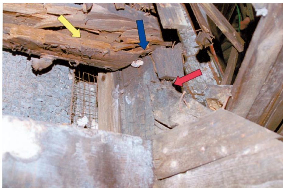
Der obere Druckring (gelber Pfeil) war völlig verfault. Die Zugsäulen waren am Anschlusspunkt (blauer Pfeil) gebrochen – ebenso der Versatzanschluss der Strebe (roter Pfeil).
