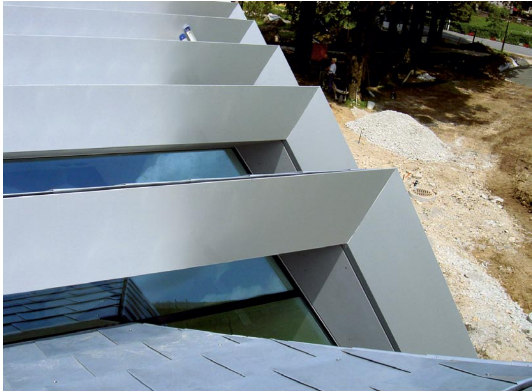
Blick vom Dach auf die Oberlichter: Die offenen Versatzflächen zwischen den Bügeln sind umlaufend verglast und bilden großzügige Verglasungen.
