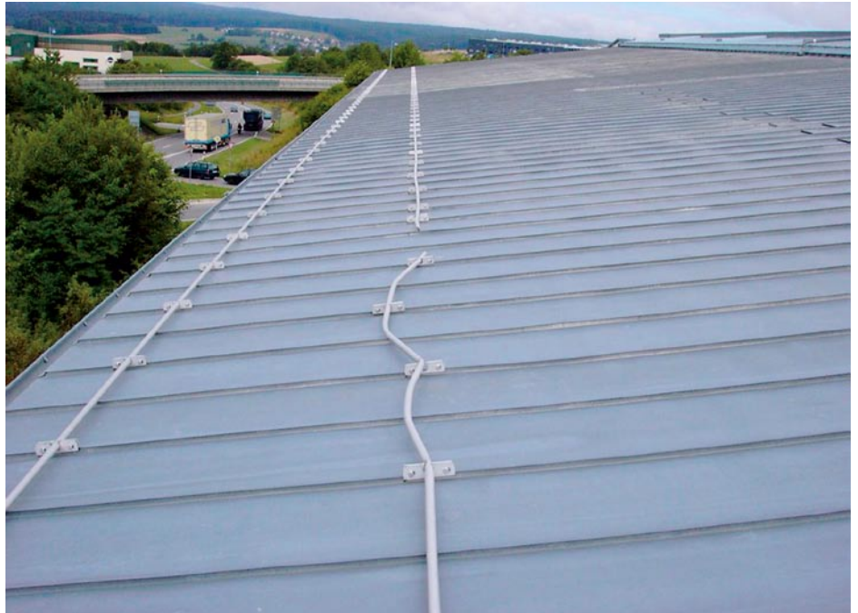
... aber in einer schneereichen Gegend war dieses zu schwach bemessen. Die Schneemassen haben die Rohre verformt und somit konnten die überhängenden Schneebretter die Dachrinne deformieren.
