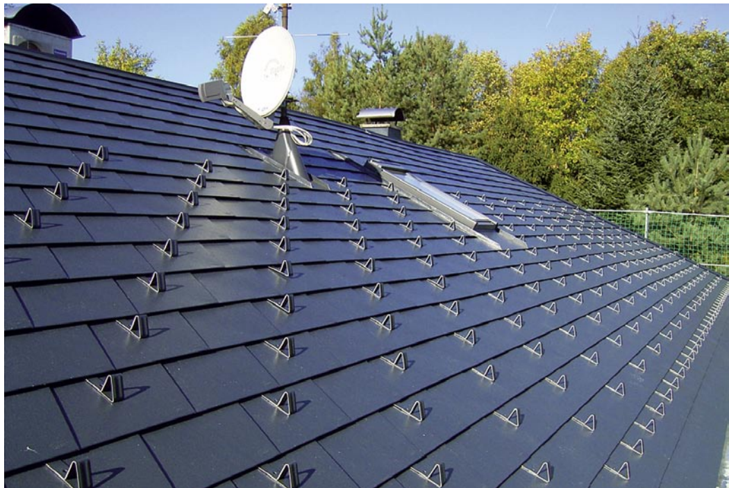
▼ Die Möglichkeiten sind vielfältig: Bei den Dachschindeln wurde ein Schneestopper-System im engen Raster eingebaut ...
