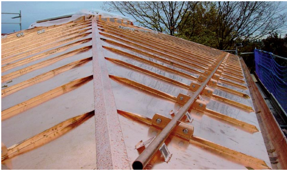
◀ Hier dürfte nichts mehr passieren: Das Schneefangrohr wurde auf jedem Falz aufgeklemt und zusätzliche Eisspalter in der Schar verhindern, dass die Rinne verformt wird und dass Schneebretter oder Eisplatten vom Dach rutschen.
