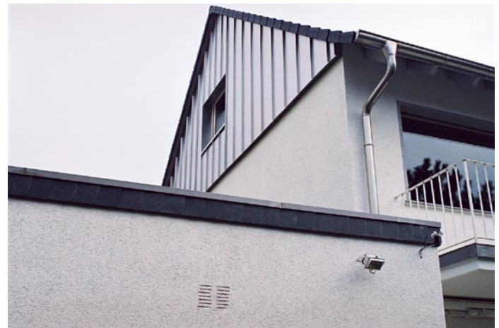
Statt bröckelndem Putzmauerwerk hat der Giebel nun eine wärme gedämmte Außenwandbekleidung aus Edelstahl.
