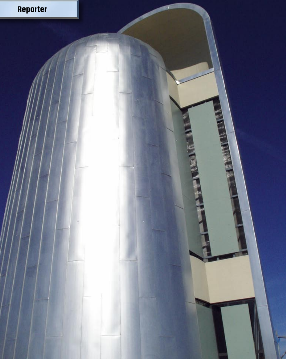
Bild 11.: Nach dem Gerüstabbau hebt sich der glänzende Bilfinger Kirchturm vor einem tiefblauen Himmel ab. Die hauerbuckel-ähnlichen Gerüststopfen fallen dabei kaum auf.
