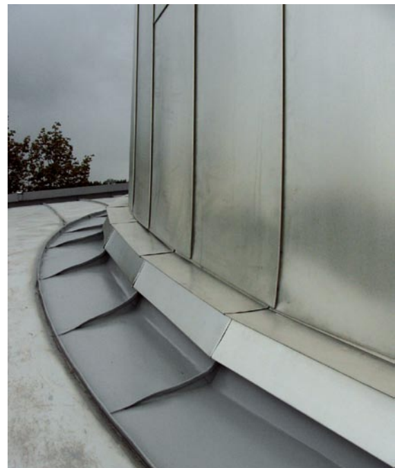
Um das den Turm teilweise umfassende Aluminium Stehfalzdach vor Korrosionseinflüssen zu schützen wurden die Kehlbereiche mit Enke Metallprotekt beschichtet.
