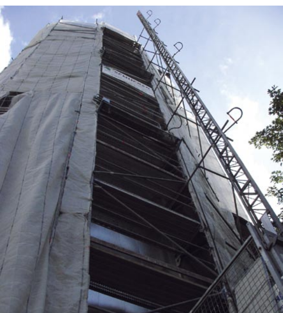
Bild 5.: Verhüllt: Vor neugierigen Blicken, Wind und Sommerhitze geschützt arbeiteten die Klempnerkollegen 11 Wochen an der Tecu-Zinn Fassade.
