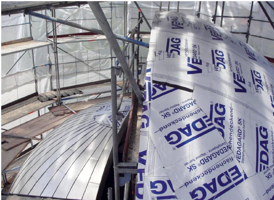
Bild 7.: Im Bildvordergrund ist die bituminöse und selbstklebende Dampfsperre deutlich zu erkennen, wobei die im Hintergrund tiefer liegende Turmkuppel bereits fast fertiggestellt ist.
