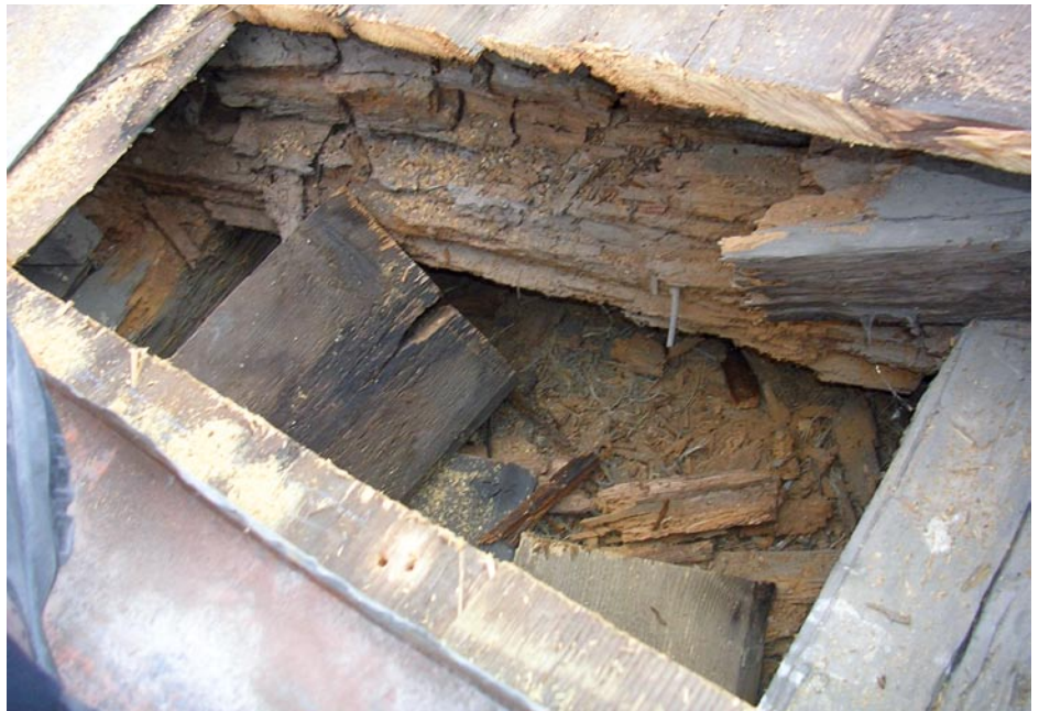
Von diesem zerbröselnden Stück Holz war nichts mehr zu retten – ein neuer Balken musste mit Hilfe der Dorfbewohner organisiert werden.
