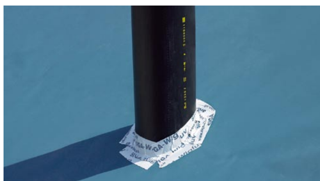
Runde Durchdringungen werden mit dem Klebeband schuppenartig verklebt. Durch das Fixieren des ersten Streifens am tiefsten Punkt bietet die Verklebung mehr Sicherheit vor eindringendem Wasser.
