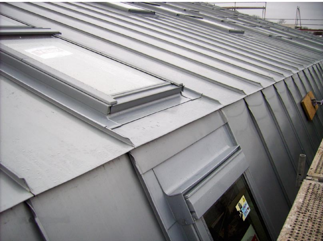
Detaillösung: Übergang vom 15°-Dach in die 60°-Fläche; „Schiebemöglichkeit“ für die Schare ist gegeben.
