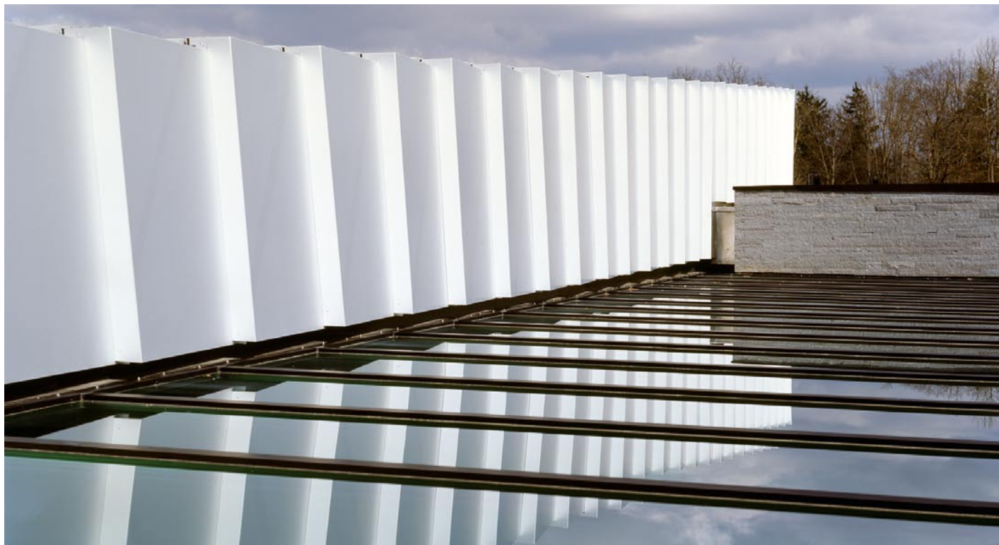
Die schuppenförmige Struktur der Aluminium-Außenfassade spiegelt sich in den Deckenfenstern der Lobby.
