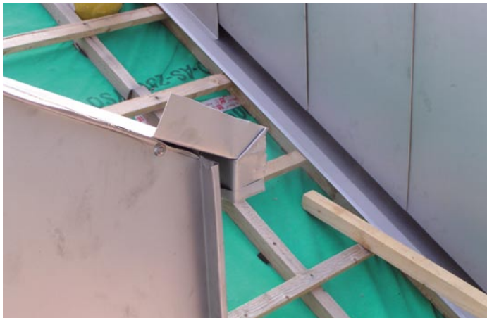
Die Hinterlüftung erfolgt zwischen dem Seitenprofil und der Fassadenbekleidung unten und der Firstentlüftung oben.
