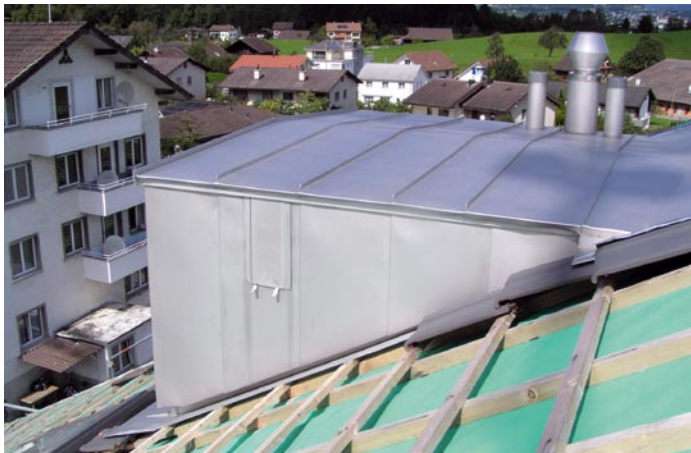
Die Serviceklappe für den späteren Satellitenanschluss kann vom Elektriker nach unten geschoben werden.
