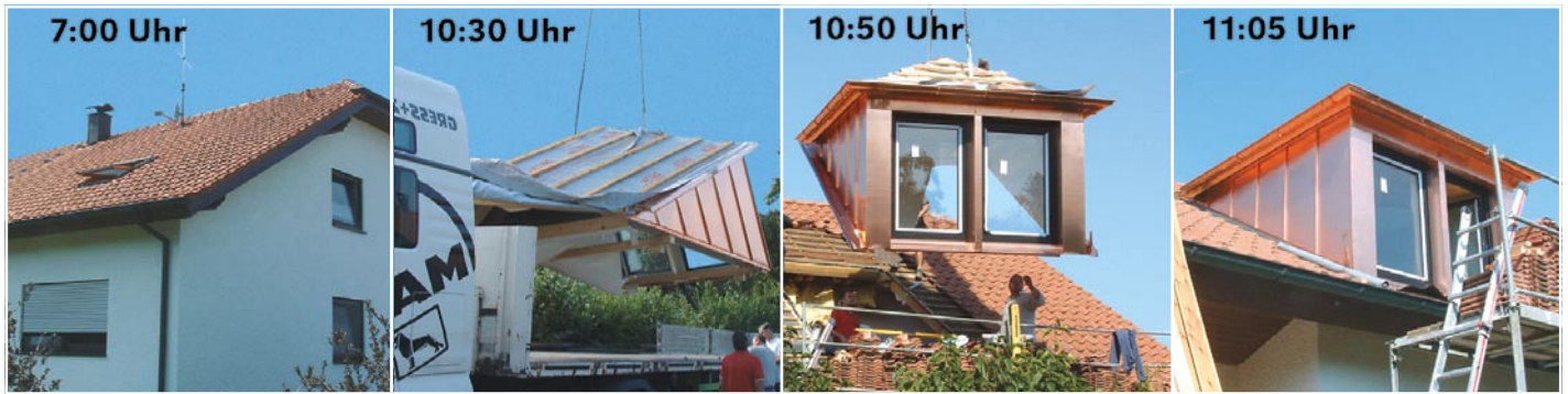
Bild 1.: Die Montage so genannter Fertiggauben grenzt fast schon an Zauberei. Wo die Hausbesitzer um 7:00 Uhr noch schliefen, entstand bereits bis 11:05 Uhr ein neuer Raum. Ob vom Systemanbieter (Bild: Mage Herzberg) oder aus Klempnerhand: Fertiggauben überzeugen Bauherren durch eine schnelle Montage, während sich der Klempner über die angenehme Vorfertigung in der Werkstatt freut.
