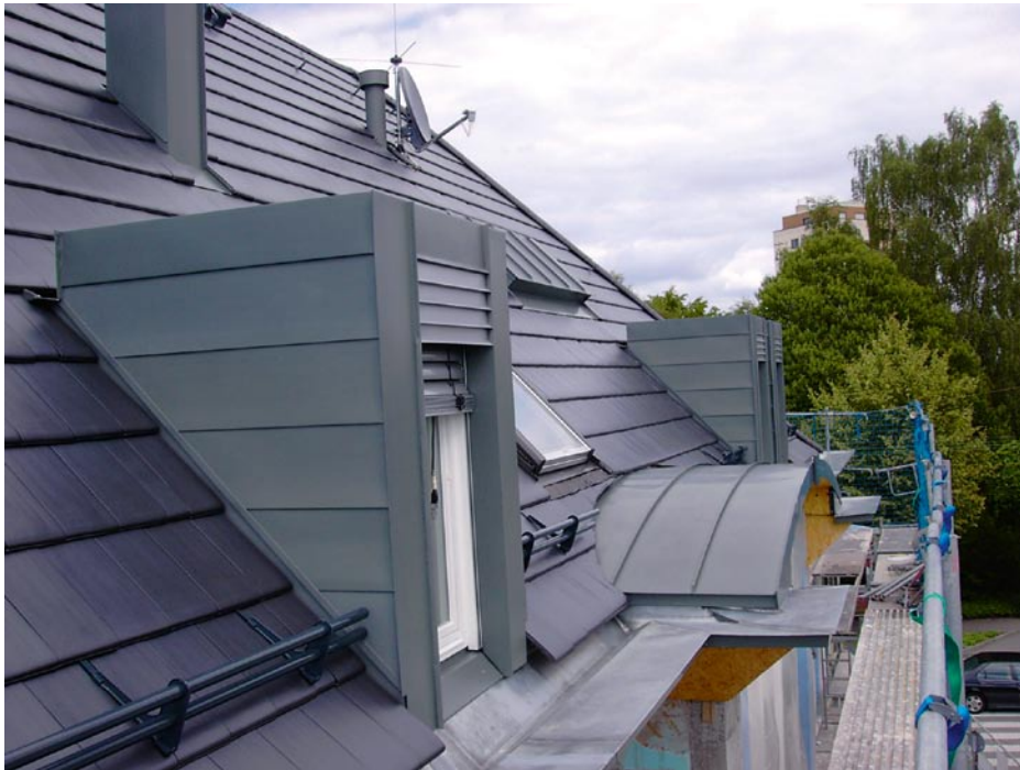
Bild 7.: Die Seitenbekleidungen dieser Gauben aus „Rheinzink vorbewittert-pro schiefergrau“ sind an das Ziegeldeckmaß angepasst.
