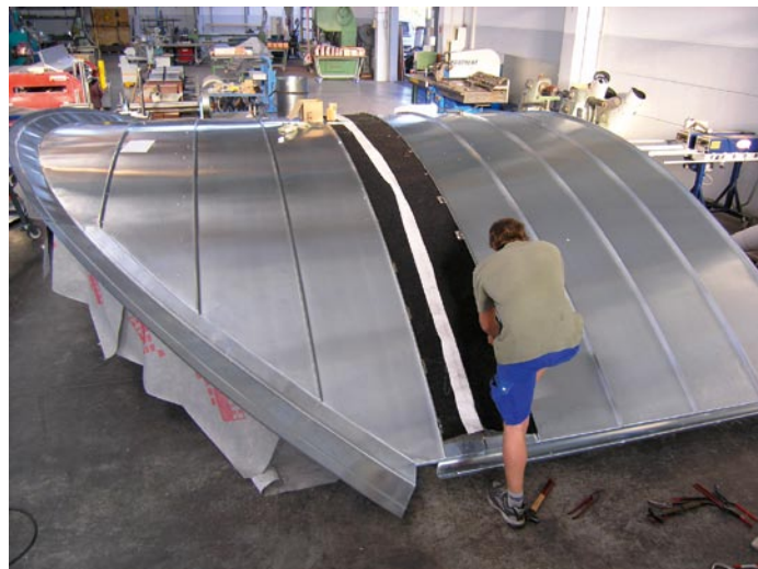
Bild 12.: Industriell vorgefertigte Kurvenkehle der Krehle GmbH aus Landsberg am Lech an einer Fertiggaube.
