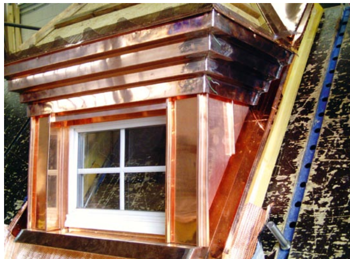
Bild 3.: Wie ein Patient auf dem Operationstisch ist diese Gaube festgeschnallt. Der schwenkbare Arbeitstisch simuliert die Dachschräge und ermöglicht angenehmes Arbeiten in der Werkstatt. Sehenswert ist auch die dichte Verbindung von Seitenkehle und Traufabschluss.
