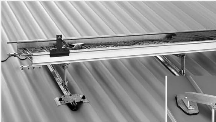
Montage eines Wartungssteiges mit Rutscher als Anschlagpunkt und Sicherheitsgeschirr auf Welle 5. Abbildung rechts: Halterung für Stehfalzdächer.
