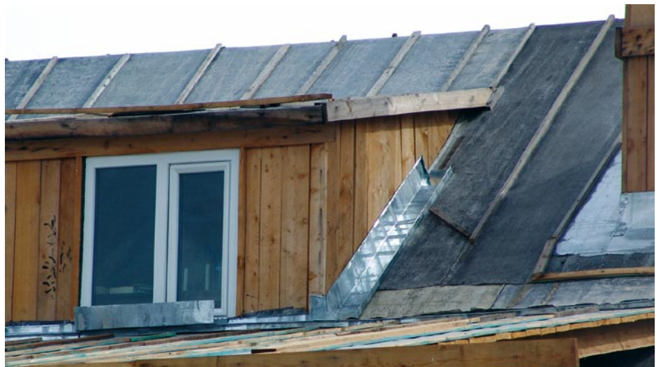
Auf einer selbst gebastelten Abkantbank entstanden Kehlprofile, die den hölzernen Neubau vor mongolischer Witterung schützen.
