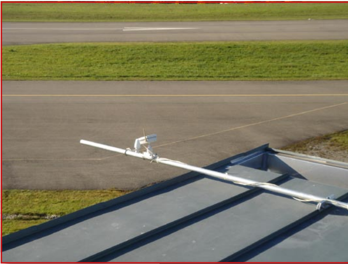
Zuhäuf sind technische Geräte sichtbar auf dem Titanzink-Dach montiert.
