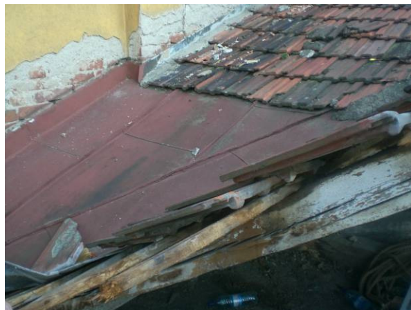
Bild 18: Die Kehlflächen in völlig desolatem Zustand
